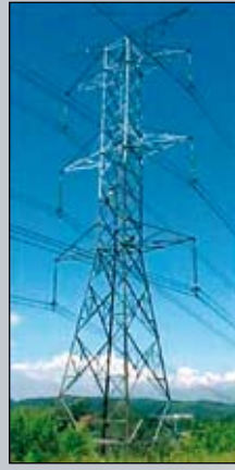
Postes de alta tensión, Brasil
