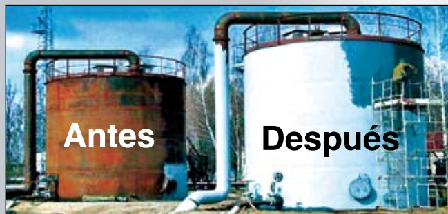
Estación de bombeo de Kobrin, República de Belarús
